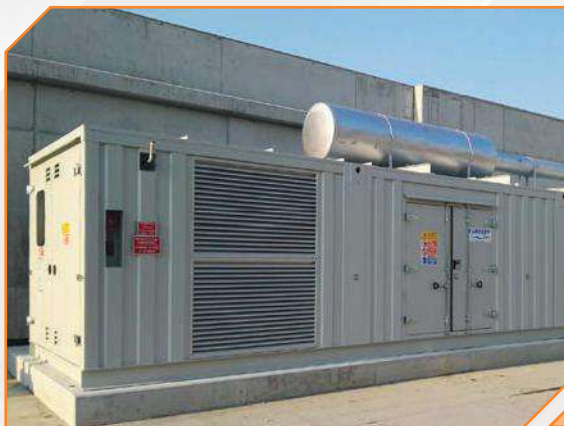
CENTRO COMMERCIALE VIMERCATE GENSET 1130 KVA 55 DB(A) A 7 MT.
