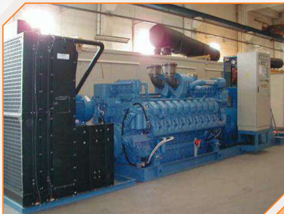
CENTRALE EDISON DI SIMERI CRICHI GENERATORI DA 2500 KVA
