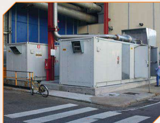
FUSINA 2X630KVA N°2 GRUPPI ELETTROGENI AVENTI POTENZA 630KVA
