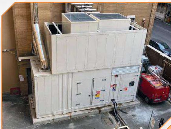
TELECOM BERSAGLIO GE 1250KVA
