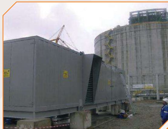
CENTRALE DI STOCCAGGIO LNG-TECHINT C/O GATE TERMINAL MAASVLAKTE ROTTERDAM GENERATORI DA 1650 KVA.
