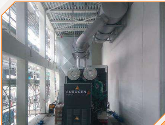
CENTRO COMMERCIALE GENOVA 1000KVA
