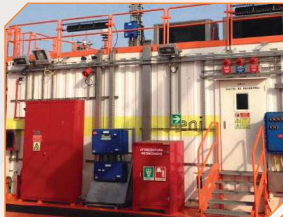
ROSETTI MARINO SPA PIATTAFORMA OFFSHORE NEL MAR ADRIATICO GRUPPO DA 400 KVA
